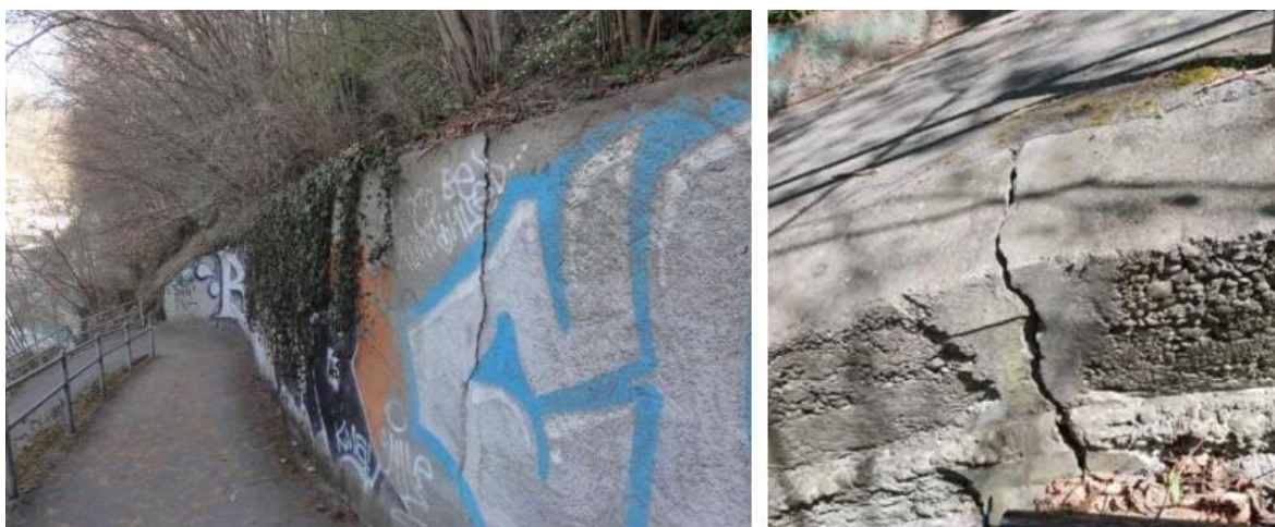
Abb. 15: Stützmauern mit Verschiebungen und Rissen
