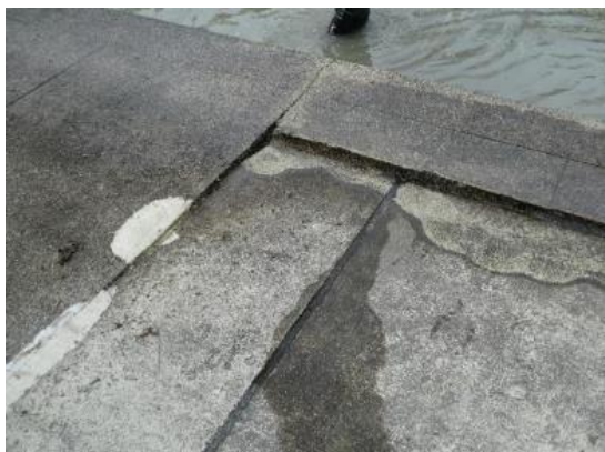
Abb. 6: Stolpergefahr bei Zugang Becken
