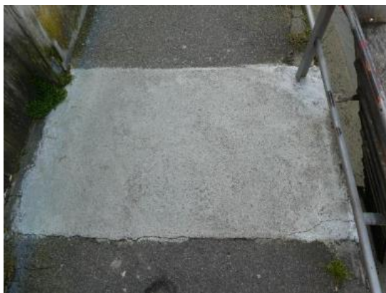
Abb. 5: Behebung von Rissen im Belag
