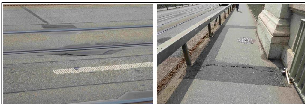
Abbildung 1: Belagsabplatzungen bei Schienenbefestigungen, Belags- und Fugenrisse
