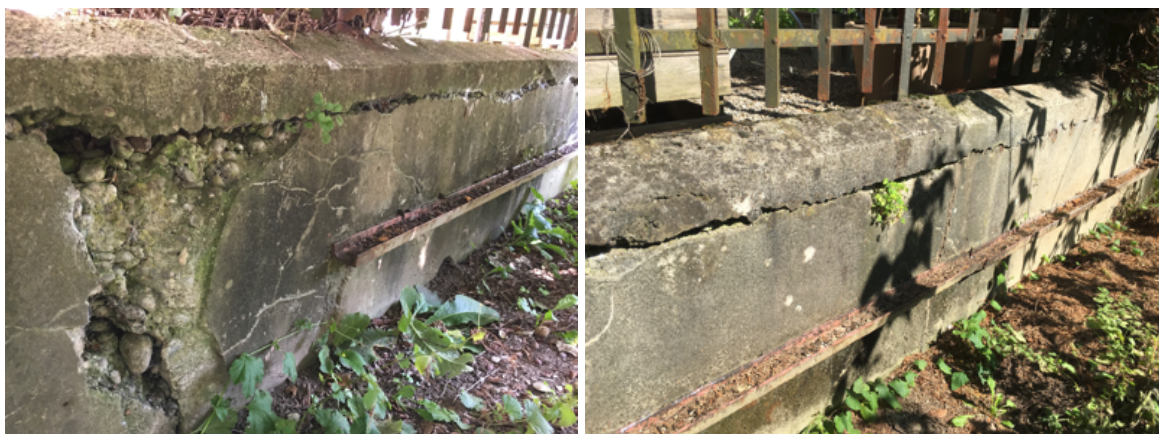
Abb. 10 und 11: Schadensbild Einfriedungsmauer
