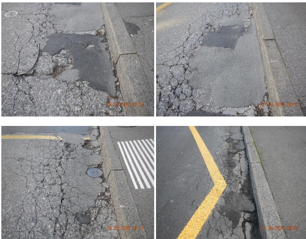
Abbildungen 1-4: Bilder des schadhaften Belags auf der Länggassstrasse
