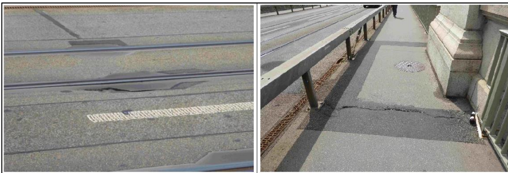
Abbildung 1: Belagsabplatzungen bei Schienenbefestigungen, Belags- und Fugenrisse
