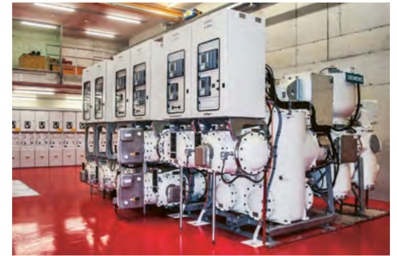
Bild 1: Das neu sanierte Unterwerk Engehalde.
