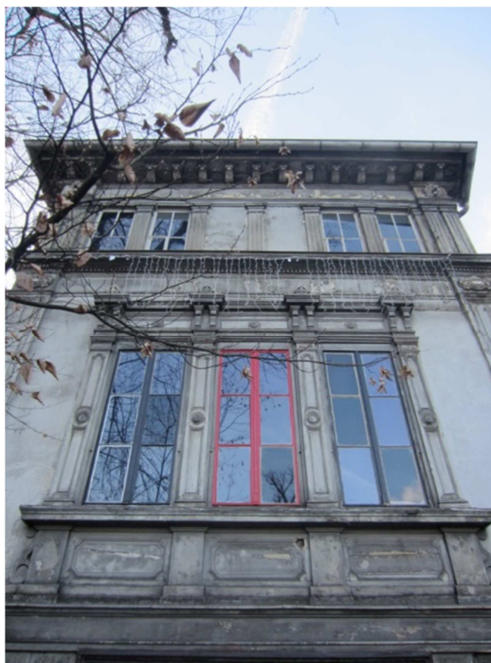
Die Fassade ist in einem schlechten Zustand.
