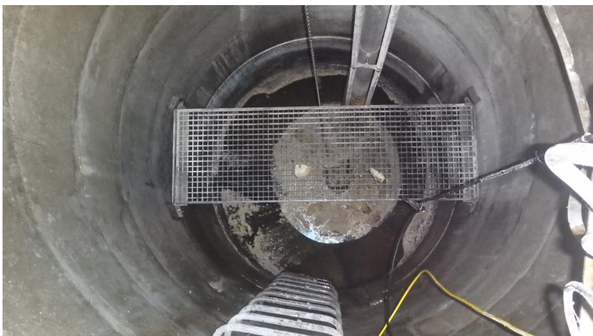
Abbildung 3: Pumpensumpf: Betonschäden, korrodierte Bewehrung, Podest korrodiert/nicht SUVA-konform
