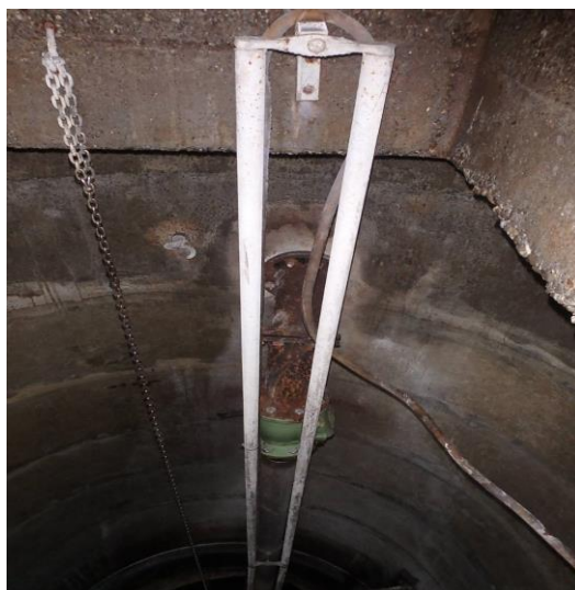
Abbildung 1: Führungseinrichtung Tauchpumpe mit Druckleitung im Hintergrund
