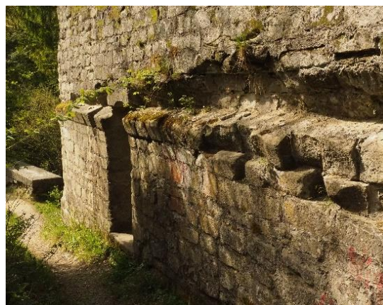
Heutiger Zustand schadhafter Mauersockel
