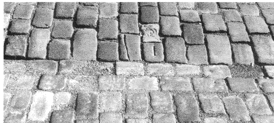
Die Gassenpflasterung ebenso wie die im Boden verlegten Werkleitungen haben in den letzten Jahren unter den massiv gewachsenen Belastungen stark gelitten.
