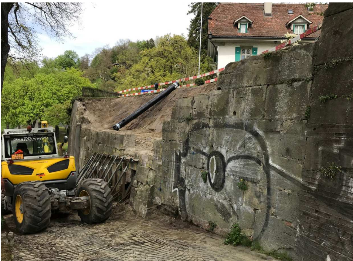
Situation nach der letzten Notmassnahme, 25. April 2019
